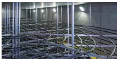
Blick in das Innere des Eis-Energiespeichers
