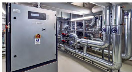
Das Blockheizkraftwerk Vitobloc 200 liefert den Strom zum Betrieb der Wärmepumpe.
