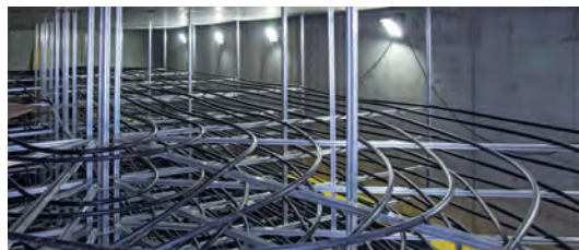
Blick in das Innere eines Eis-Energiespeichers.
